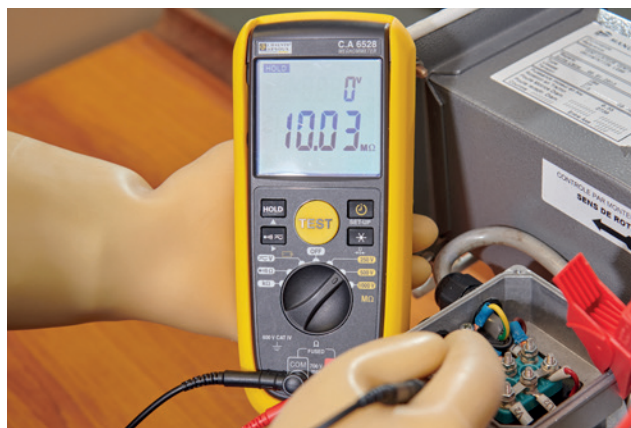
Manutenzione preventiva di un motore
